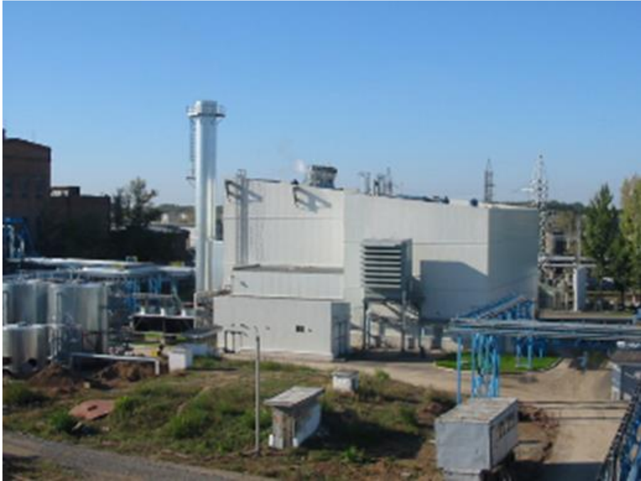
完成したガスタービン・コジェネレーション設備
