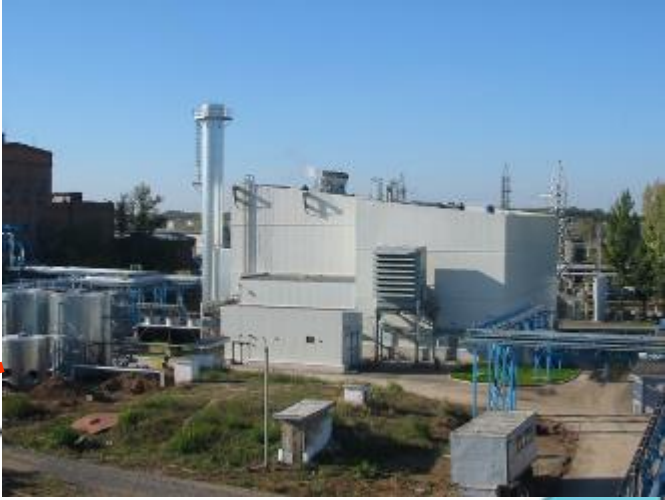
新設ウラルスク熱電供給設備全景
